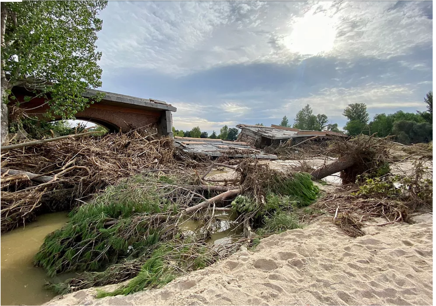
El puente de la Pedrera de Aldea del Fresno, tras el paso de la Dana. L. B. B.
